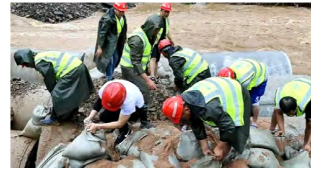
二公局乔水项目部组建70余人的突击队，调集各类机械设备10余台、沙袋5,000个，参与荥阳市水毁路段救援。经过12小时紧急救援，成功疏通道路，5,000名被困村民安全转移
